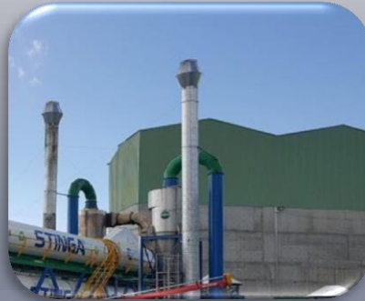
Baca çıkış sıcaklığı 72 °C Doğalgaz emisyon değerlerinin altında baca gazı ölçümlerimiz mevcuttur
